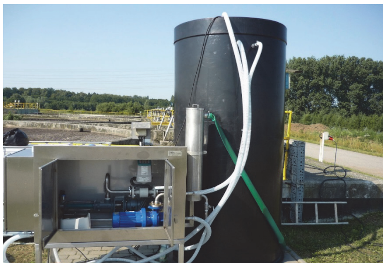
Rys. 2. Zdjęcie instalacji membranowej stosowanej do badań w COŚ Fig. 2. The photo of the membrane installation used in the COŚ treatment plant
